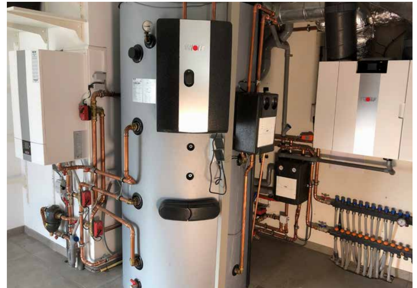
In de bijkeuken in Lichtenvoorde is tevens een WOLF BSP-W1000 meerlagenbuffervat geïnstalleerd en gekoppeld aan de warmtepomp.
