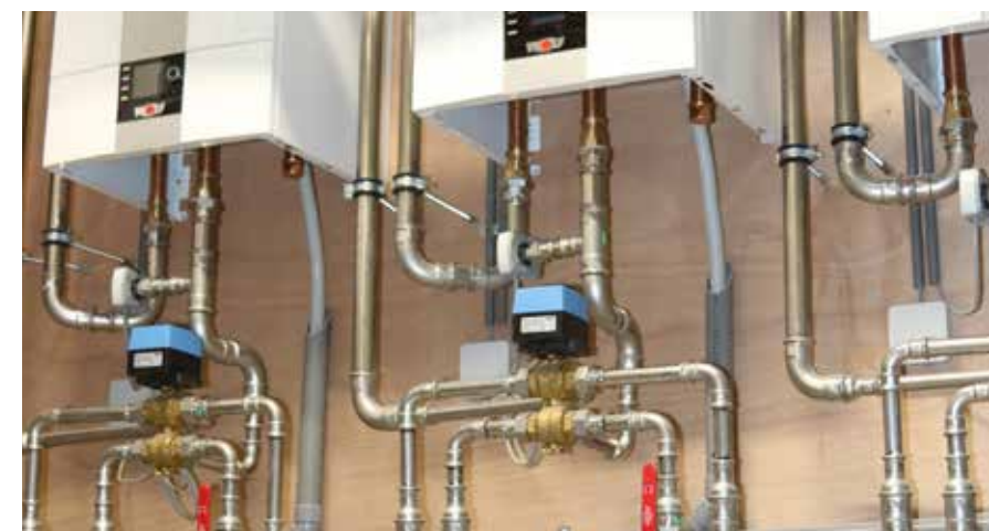
De binneneenheden van de CHA warmtepompen.
