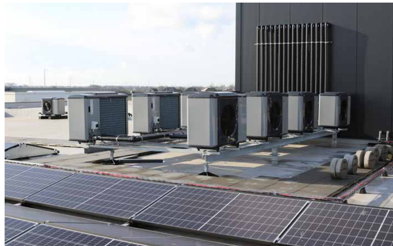
Cascadeopstelling van de CHA buitendelen op het dak.
